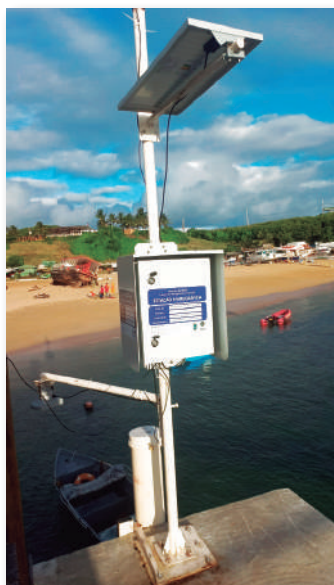
Figura 3 – Estrutura do marégrafo
