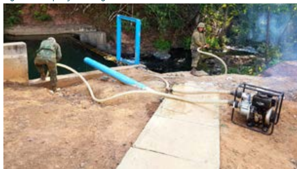
Figura 1: Captação de água.
