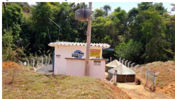
Figura 2: Tratamento de água.
