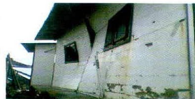
Avarias causadas pelo impacto das ondas na Estação Científica do ASPSP
