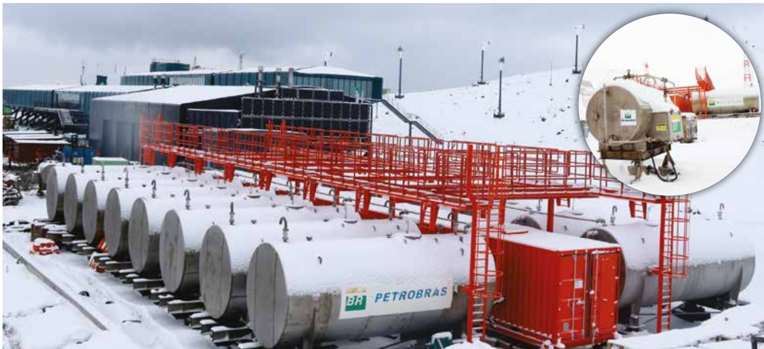
Parque de tanques da EACF.
