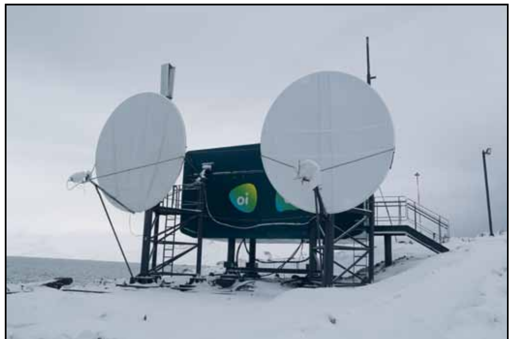
Módulo de Telecomunicações
