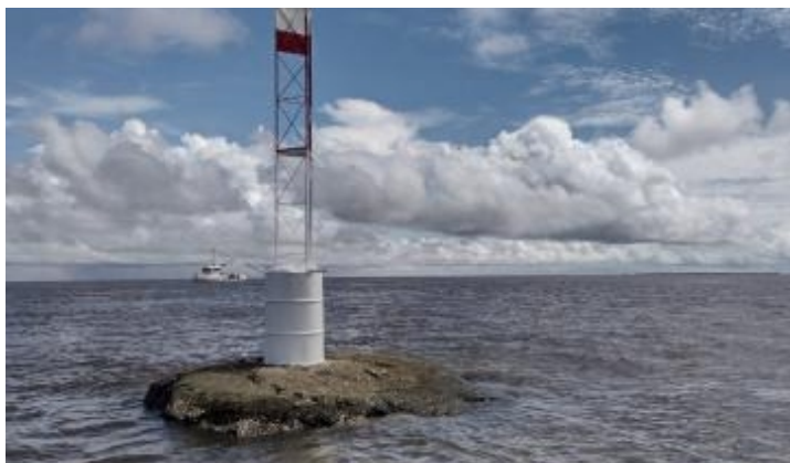
O Centro de Hidrografia e Navegação do Norte realizou a reconstrução do farolete Pedra do Machado, localizado próximo à Ilha Carnapijó, no rio Pará, com emprego do Aviso Balizador “Denébola”. Desde 2016, o farolete estava em condição irregular classificado como “destruído”. Ele foi restabelecido após a realização de um estudo técnico e aprimoramento na confecção de material de estrutura mais adequado para suportar as condições climáticas mais adversas
