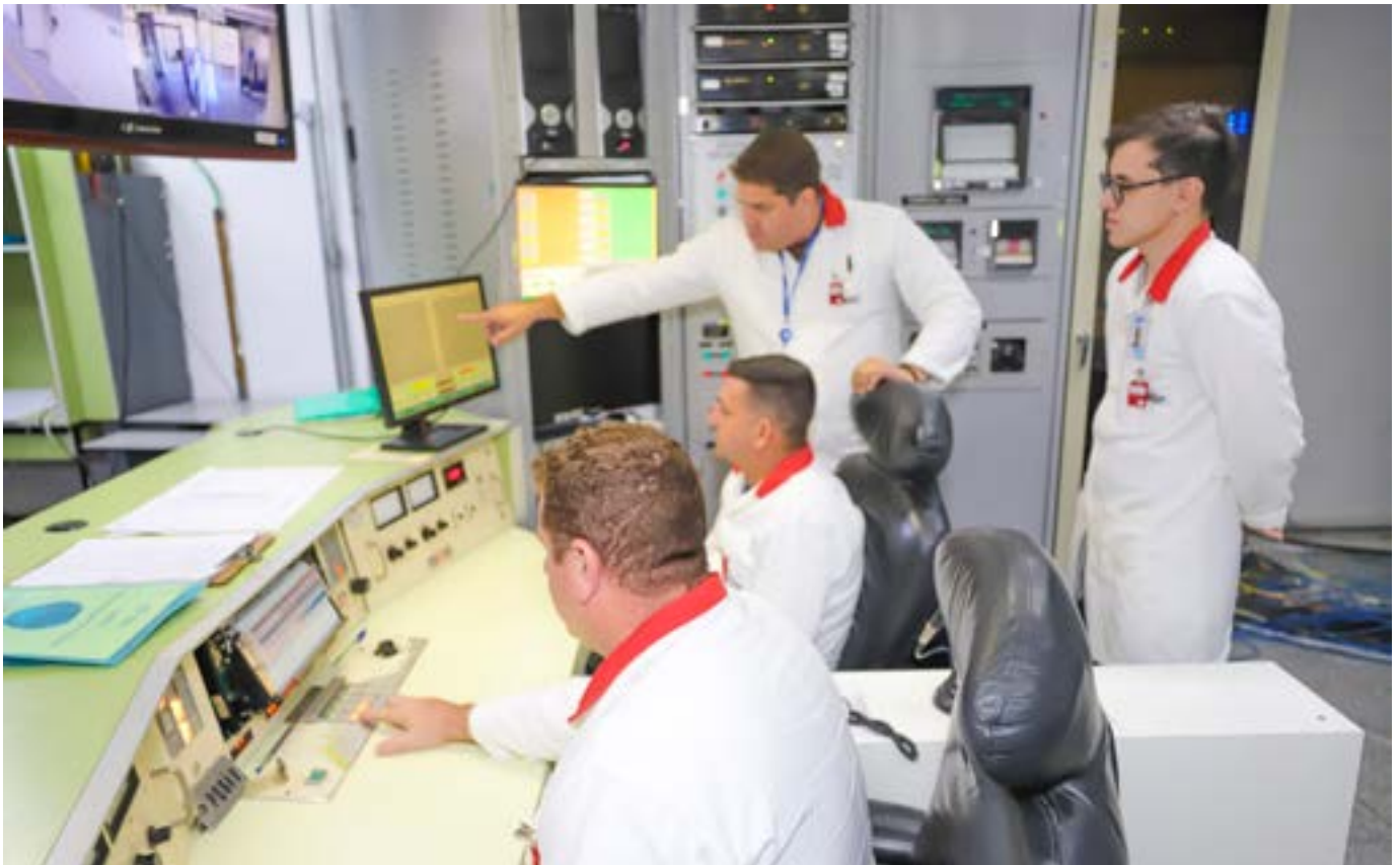
Treinamentos práticos e teóricos ocorreram nas instalações do Prédio do Reator
