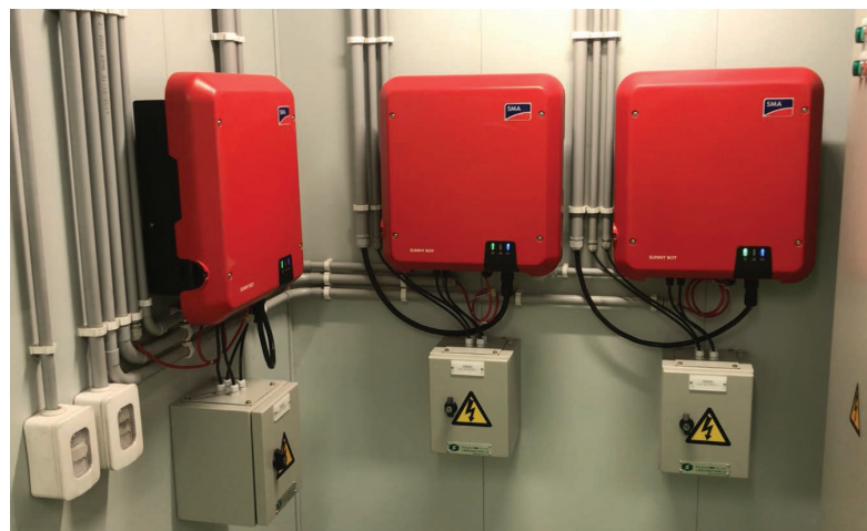
Figura 4 - Inversores solares da nova EACF. Fonte: SECIRM, 2020.
