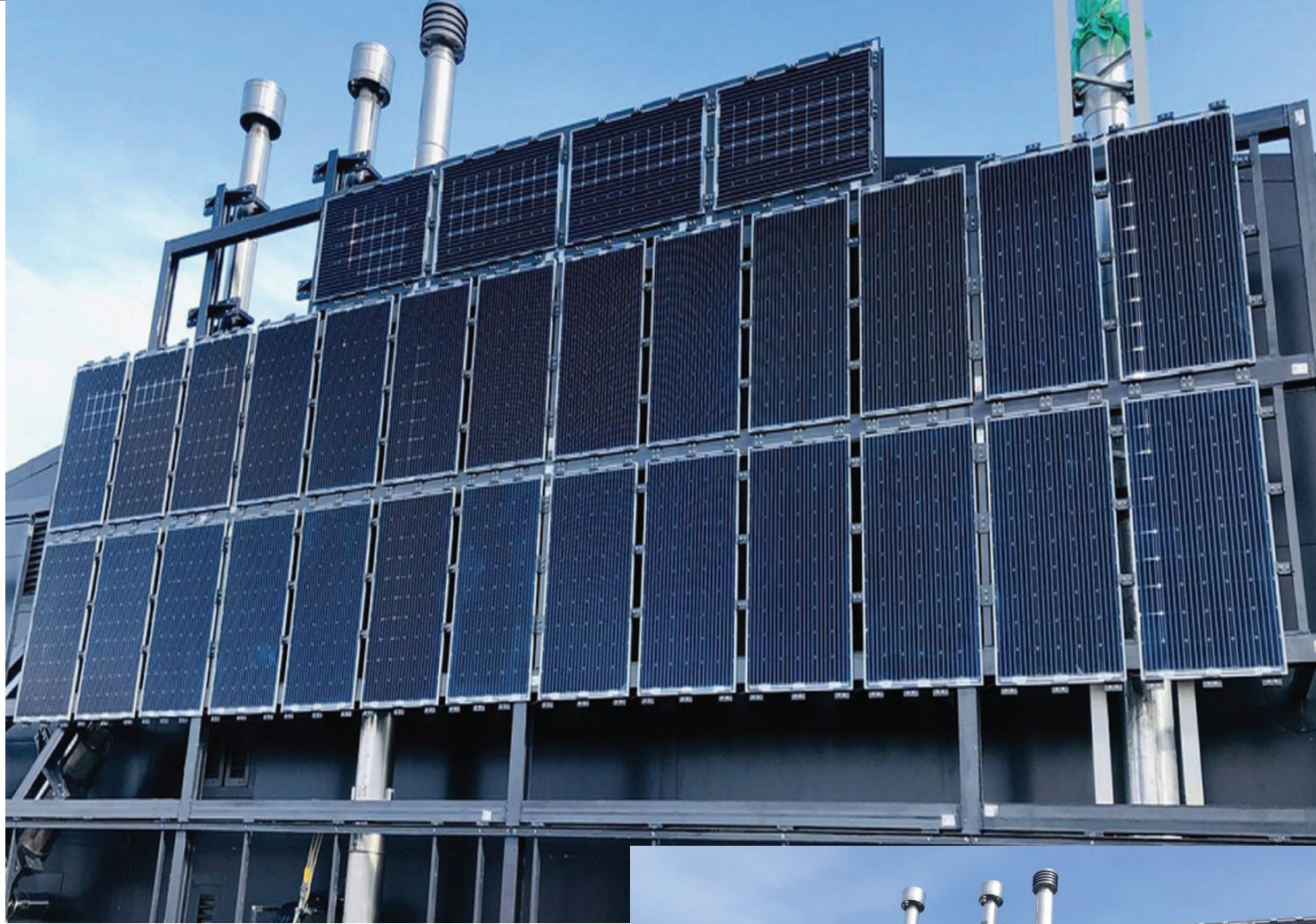
Figura 3 - Vista frontal dos módulos fotovoltaicos. Fonte: SECIRM, 2020.
