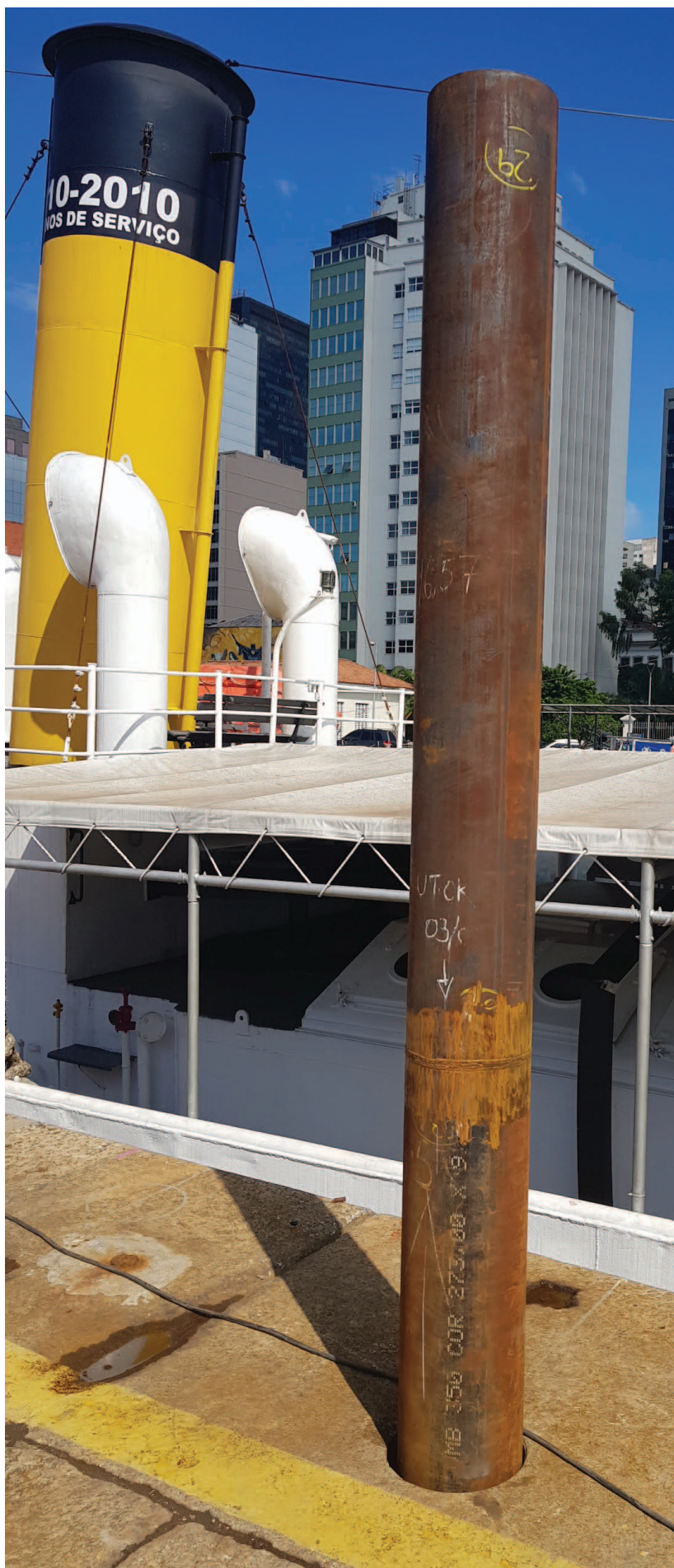
Detalhe do aspecto final de uma junta de solda executada nas estacas metálicas.
