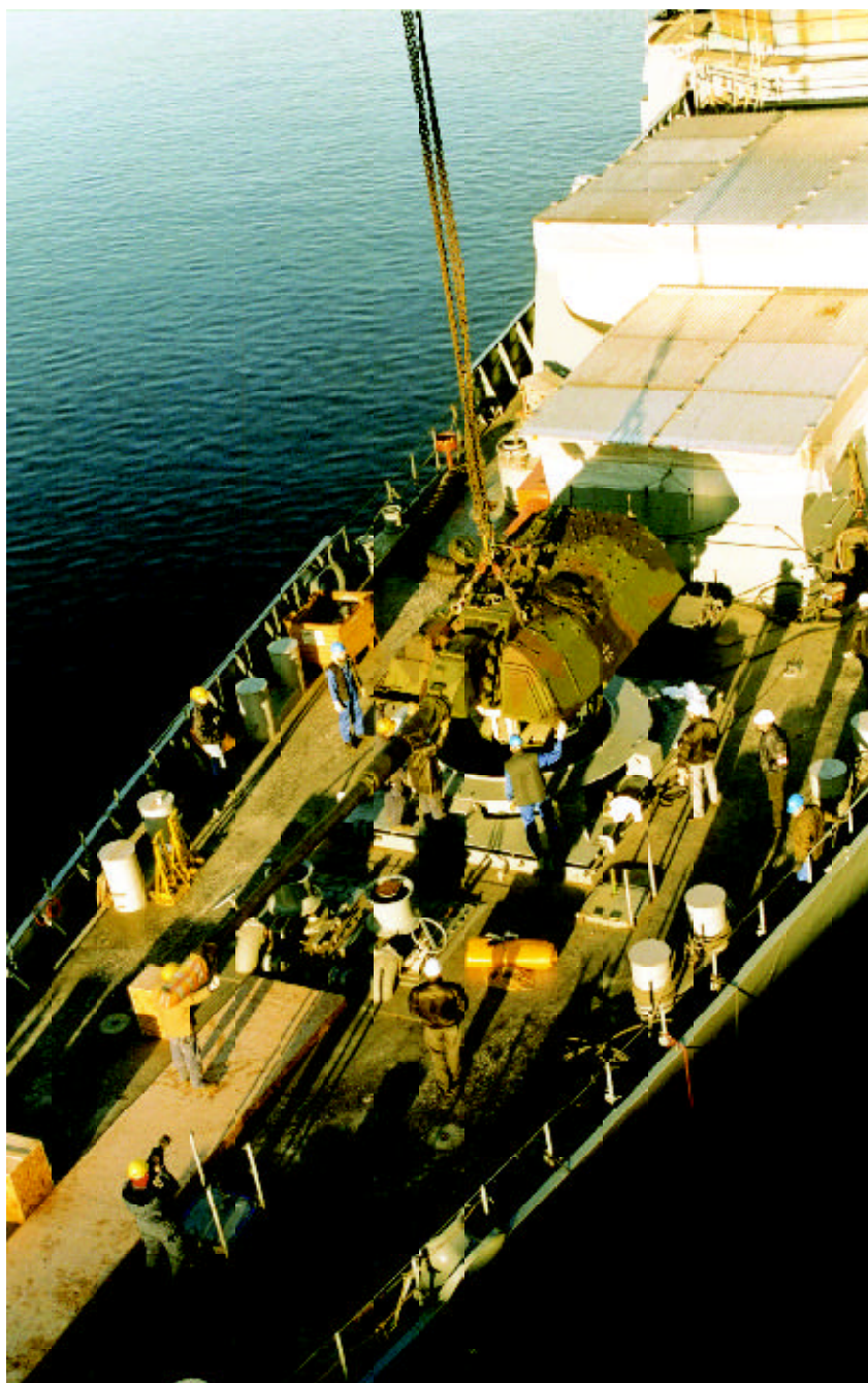
Fig. 1: Canhão de 155mm do sistema MONARC sendo instalado em uma Fragata da Marinha alemã.
