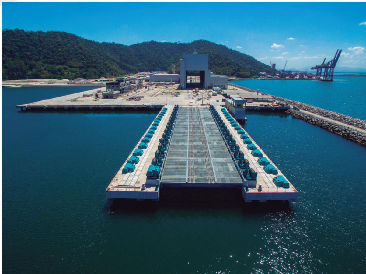
Figura 2: O shiplift será empregado no lançamento dos submarinos ao mar e no recolhimento para manutenção. Instalada em área marítima, a plataforma elevatória possui 110 m de comprimento por 20 m de largura e tem a capacidade de 8.000 t.
