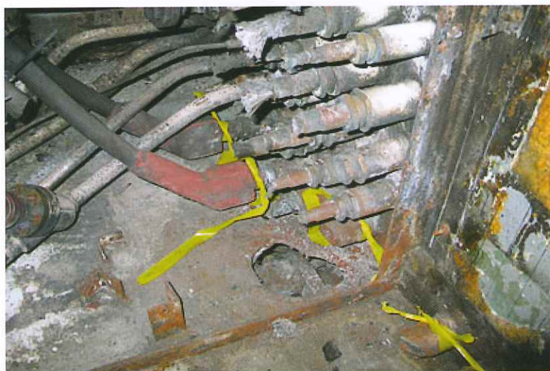
Isolamento na junção dos cabos com peças de passagem na Câmara do Comandante
