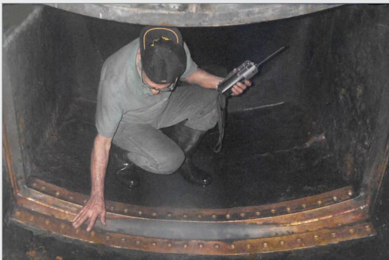
Foto 2 – Detalhe do reparo da válvula de aspiração do dique Alte. Branco, com instalação de encamisamento não ferroso na sua sede.
