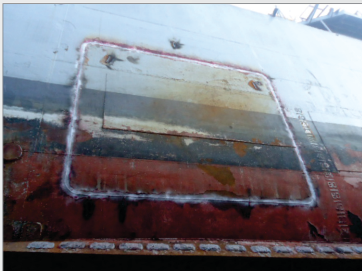
Foto 1 – Costado de boreste onde foi aberta uma das grandes cesarianas, apresentando os cordões de solda sendo testados com LP.
