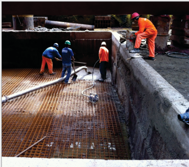
Apresentação da armadura de vergalhão e a concretagem da laje no fundo do fosso.
