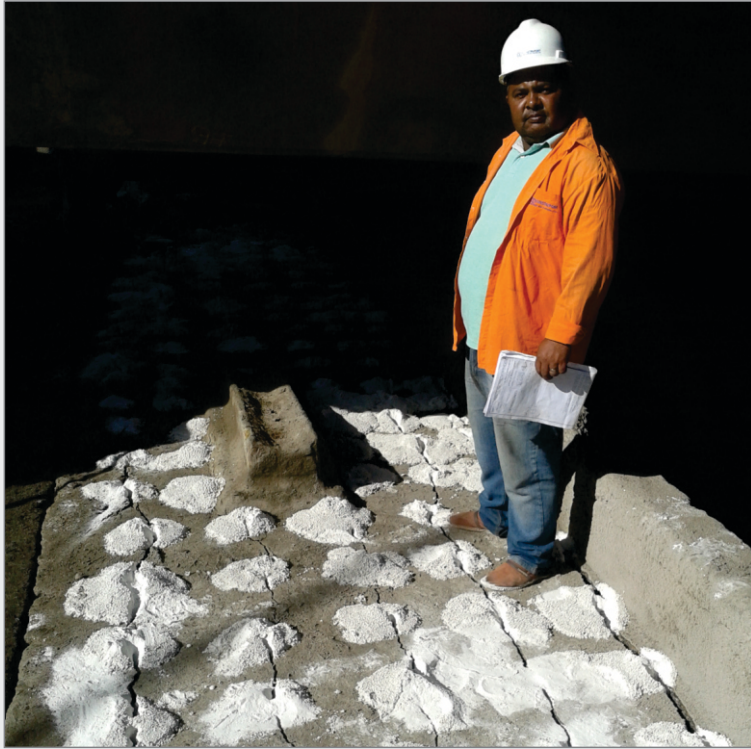
Detalhe das fraturas na rocha pela ação da cal expansiva .
