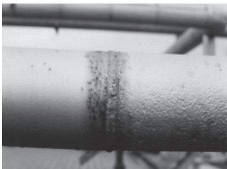
Figura 7 – Corrosão em torno de cordão de solda (Arruda, 2009)
