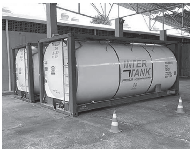
Tanques com álcool 70% para produção de álcool em gel pelo LFM (armazenado no DepCMRJ)
