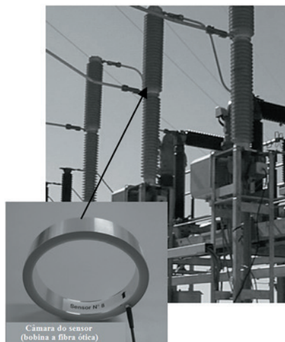
Figura 9 (b). Sensoriamento de corrente elétrica em uma subestação [7].
