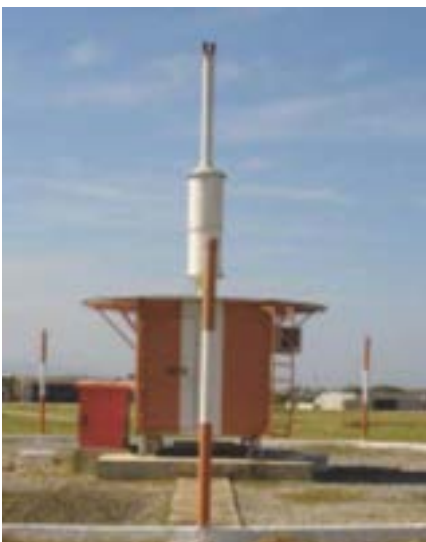
VOR convencional instalado no Aeródromo do Complexo Aeronaval.
