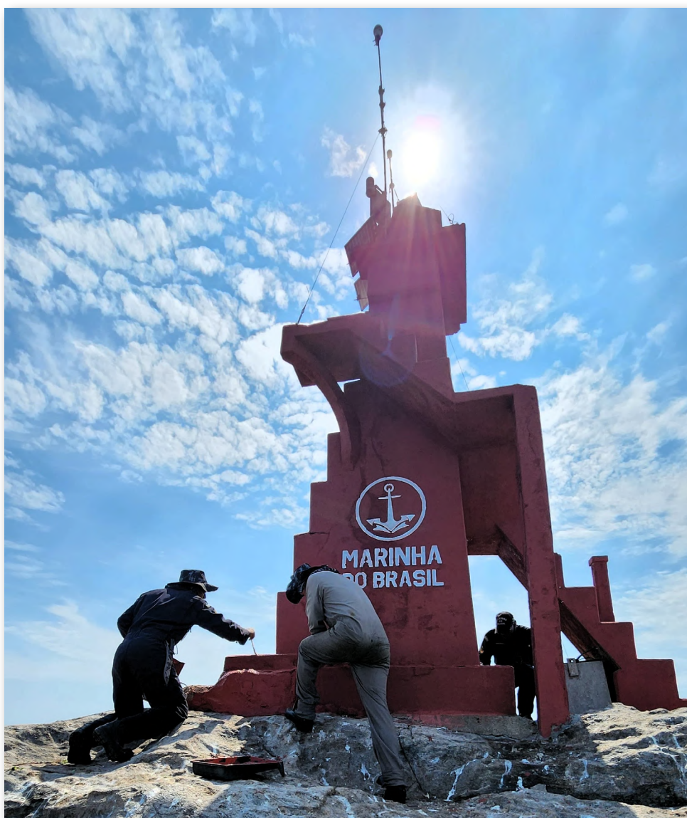
Manutenção de um auxílio à navegação.
