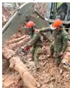
Figura 9: Desobstrução de vias em Petrópolis
