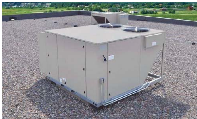
Figura 3 : Condicionador de ar tipo "roof-top"
