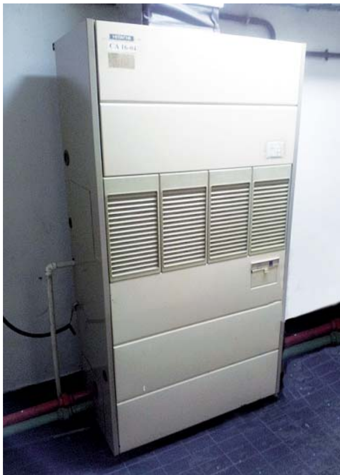
Figura 2 : Condicionador de ar tipo self-contained Fonte: Diretoria de Obras Civis da Marinha
