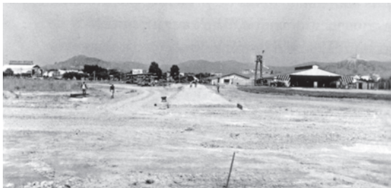
Pista de acesso em construção. Ao fundo, o hangar do ESQ HU-1 e a torre de controle. À direita, a Igreja da Penha
